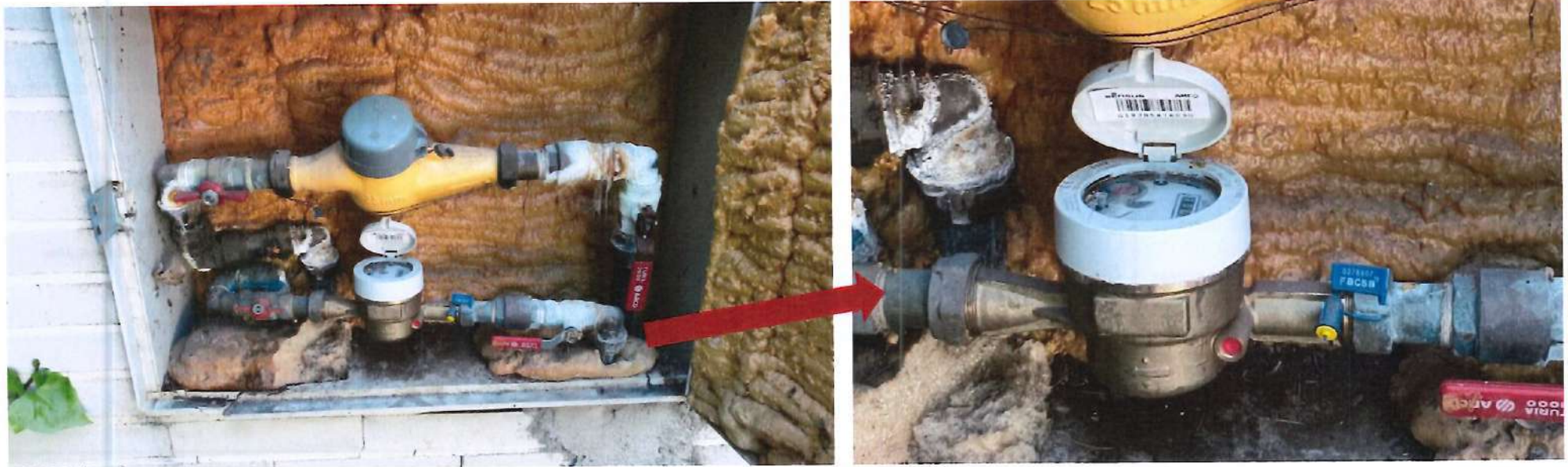
Imágenes contadores de agua
