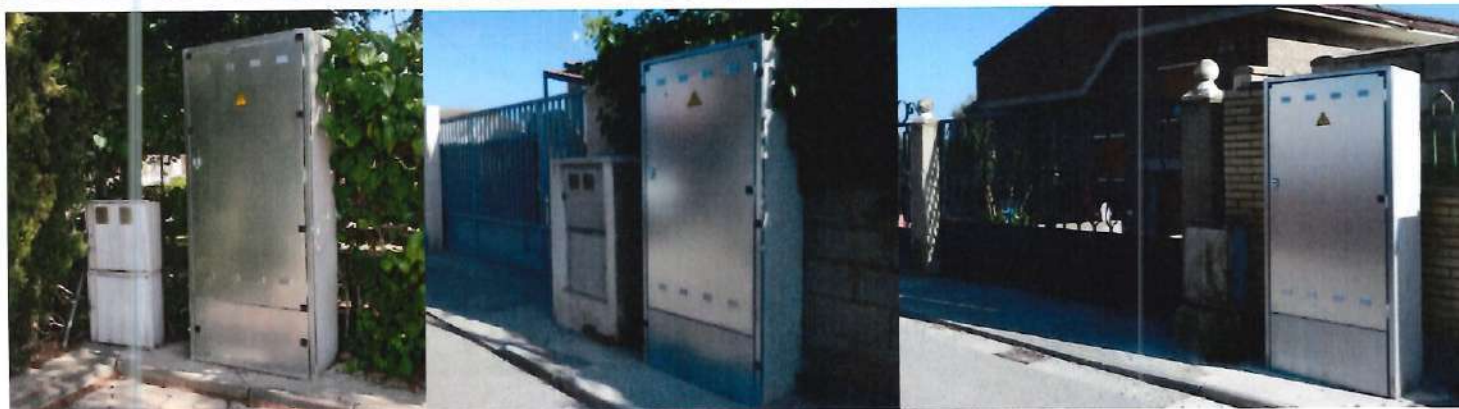
Imágenes nuevas cajas instaladas en las parcelas para la nueva red de BAJA tensión (pendientes de conexión por Endesa)
