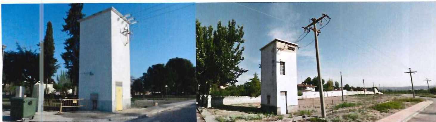
Imágenes Centros de Transformación y línea aérea ALTA y MEDIA TENSIÓN (ENDESA)
