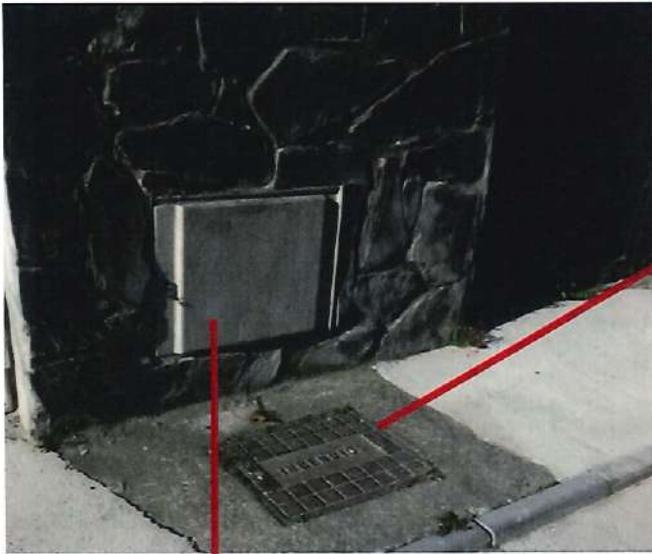
Cajas de contadores de agua
